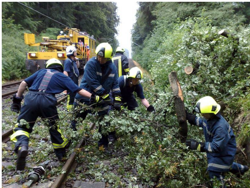
Umgestürzter Baum auf S-Bahngleisen
