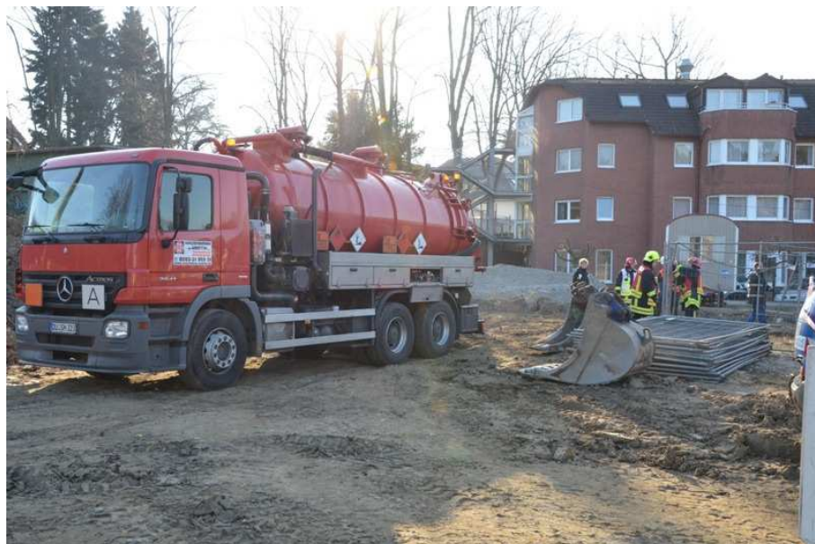
Dieseldieselkraftstoff aus Baustellentankanlage ausgelaufen
