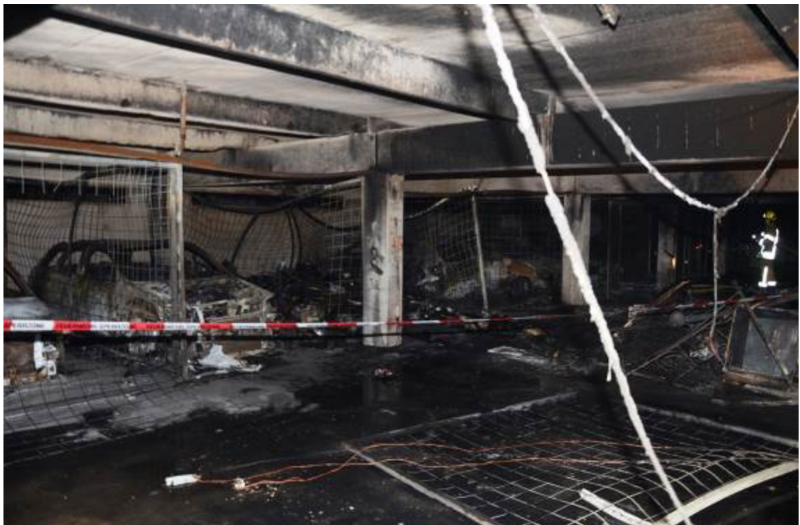
Starke Zerstörungen im vom Brand betroffenen Bereich
