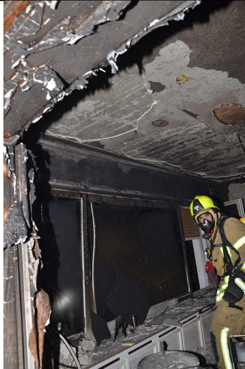
Starke Zerstörungen im Innenbereich
