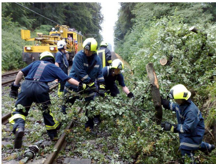
Umgestürzter Baum auf S-Bahngleisen
